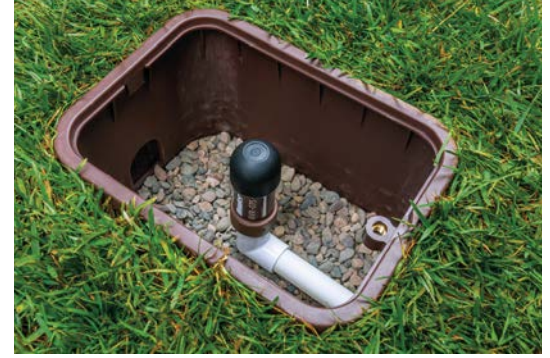
Hava/Vakum Tahliye Vanası Takılı
