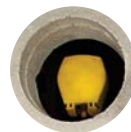
① Can Suyu Vanası
